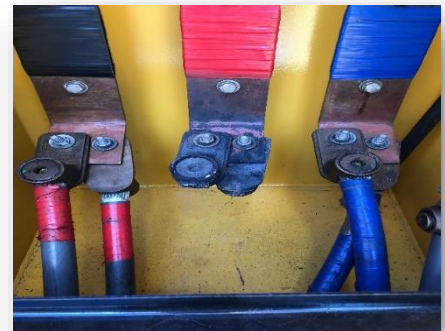
Fig. 1 - Melted Cable Lug on Generator.
